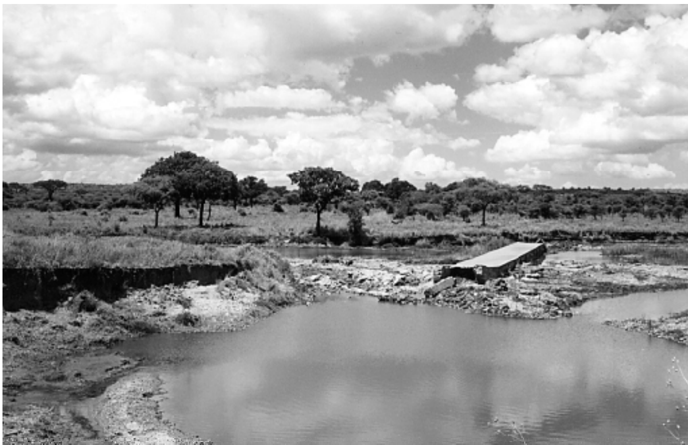
FSS-Aufgabe: Strasse und Ufer sind im Tarangire National-Park weggeschwemmt, die Betonfurt steht nutzlos im Nichts. Der Flussübergang muss wieder hergerichtet werden, um wieder Ranger-Patrouillen und Touristenfahrten zu ermöglichen.
