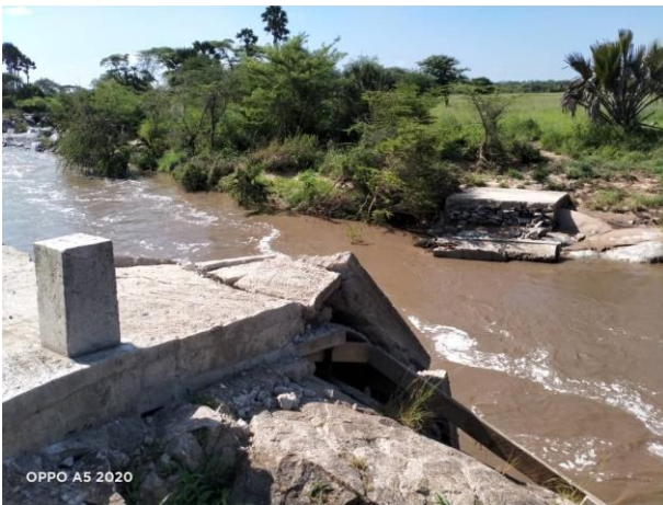
Zerstörte Nyamuma Brücke, welche im Jahr 2020 gebaut worden ist, und den starken Regenfällen zum Opfer fiel.
